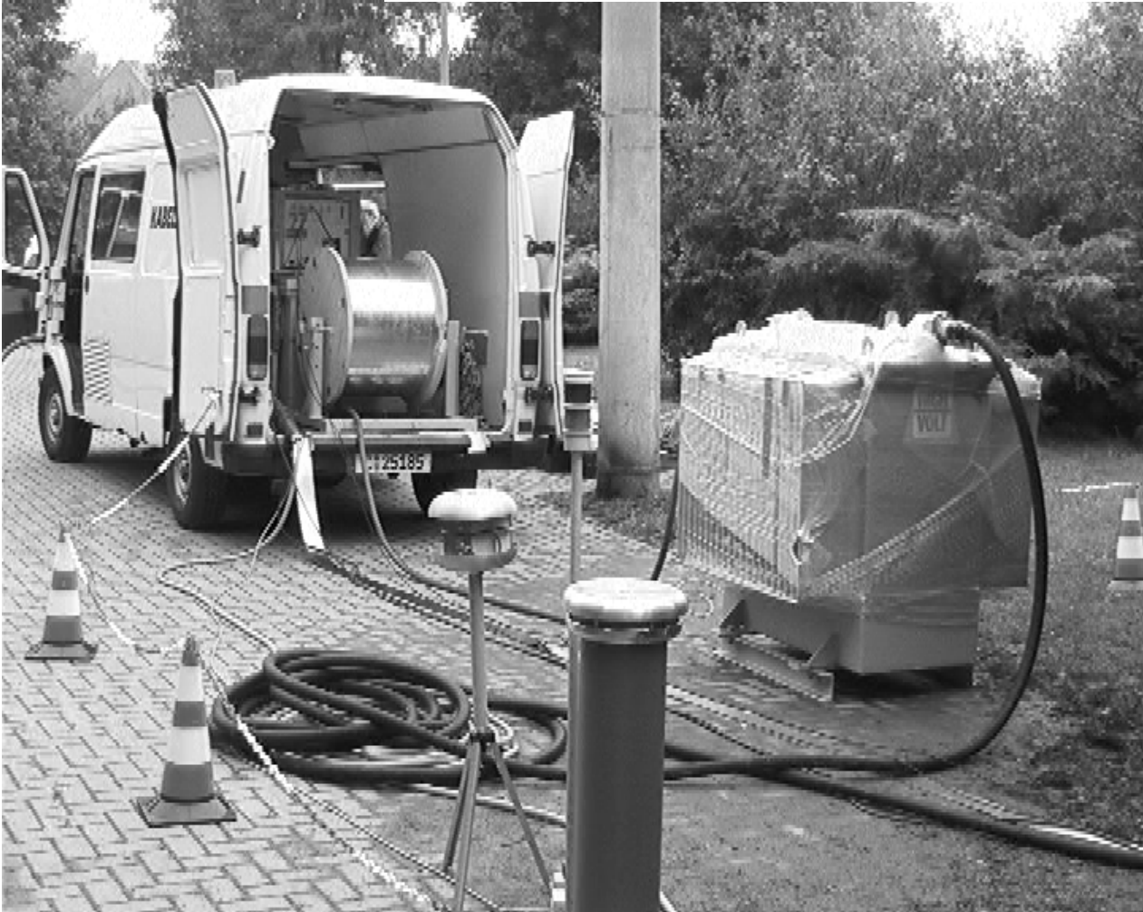
Bild 6. Prüfaufbau eines Resonanzprüfsystems variabler Frequenz für Mittelspannungskabel, Resonanzdrossel vorn rechts
